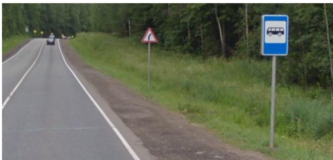
Рис. 6 Км 207+328 (справа). Автобусная остановка. Наименование «Чур». Состояние неудовлетворительное
