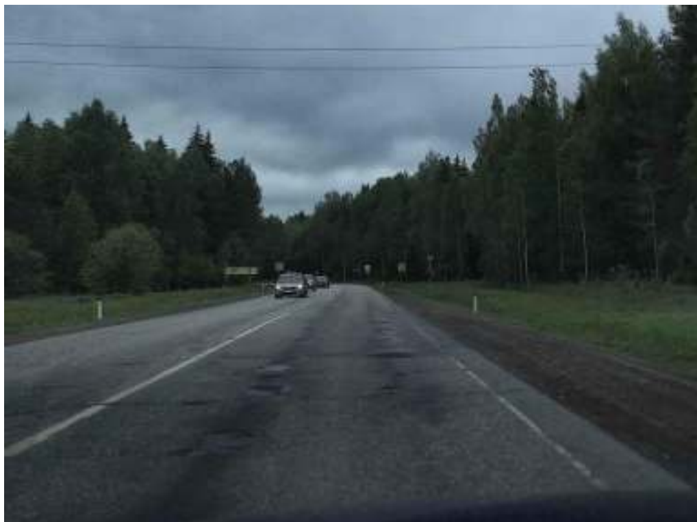
Рис.4 Состояние покрытия, правая сторона. Выкрашивание покрытия, продольные и поперечные трещины на полную глубину ДО, колея - 5-7 см.
