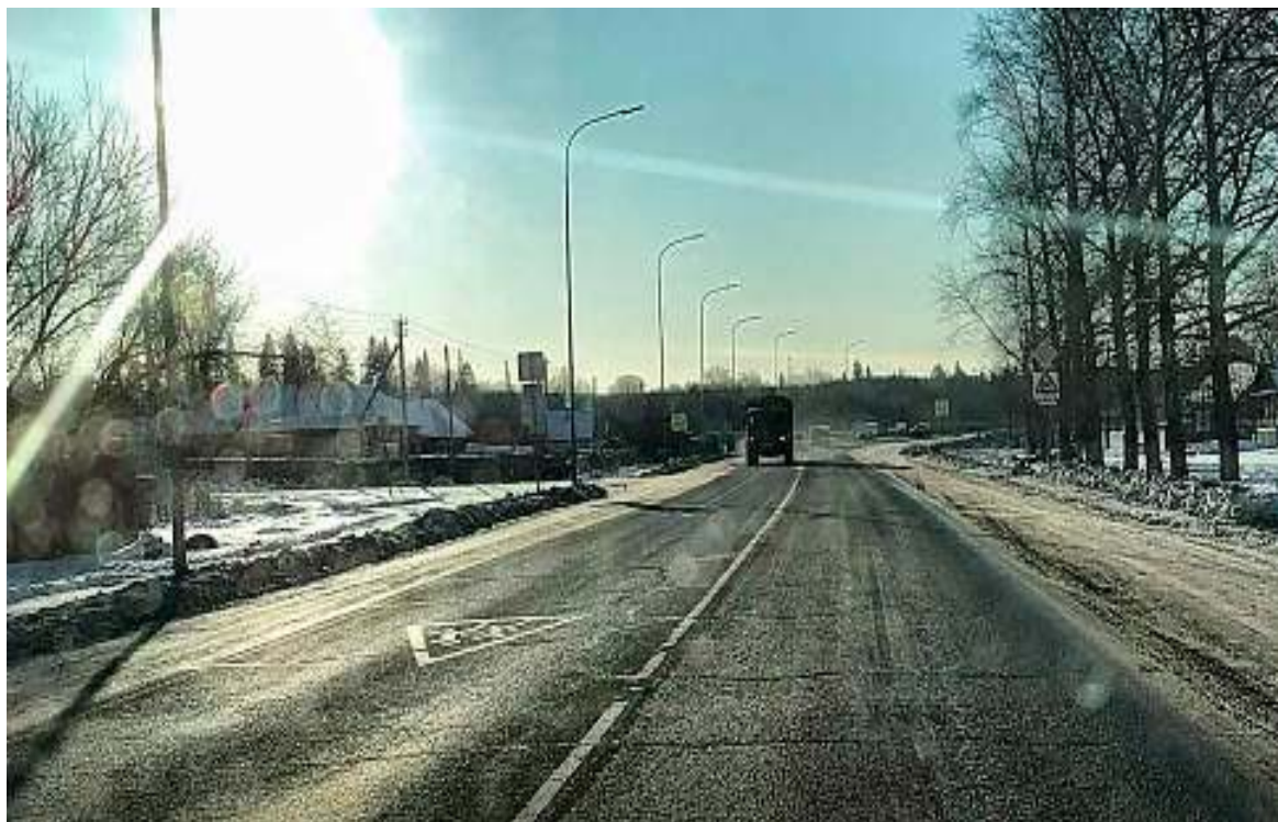
Рис.2 Состояние покрытия. Выкрашивание покрытия, продольные и поперечные трещины на полную глубину ДО, колея - 5-7 см.
