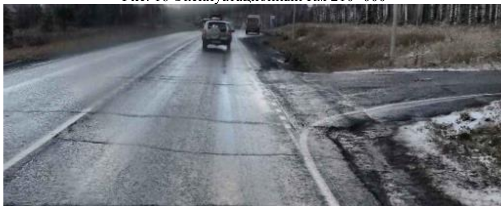
Рис.17 Км 210+053 ПК 28+39 справа. Примыкание в детский лагерь имеет а/б покрытие. Состояние неудовлетворительное
