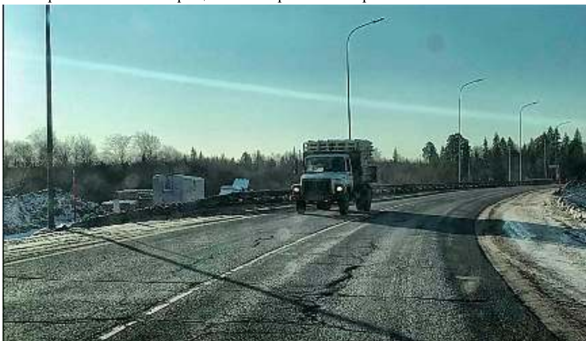
Рис.1 Состояние покрытия. Выкрашивание покрытия, продольные и поперечные трещины на полную глубину ДО, колея - 5-7 см.
