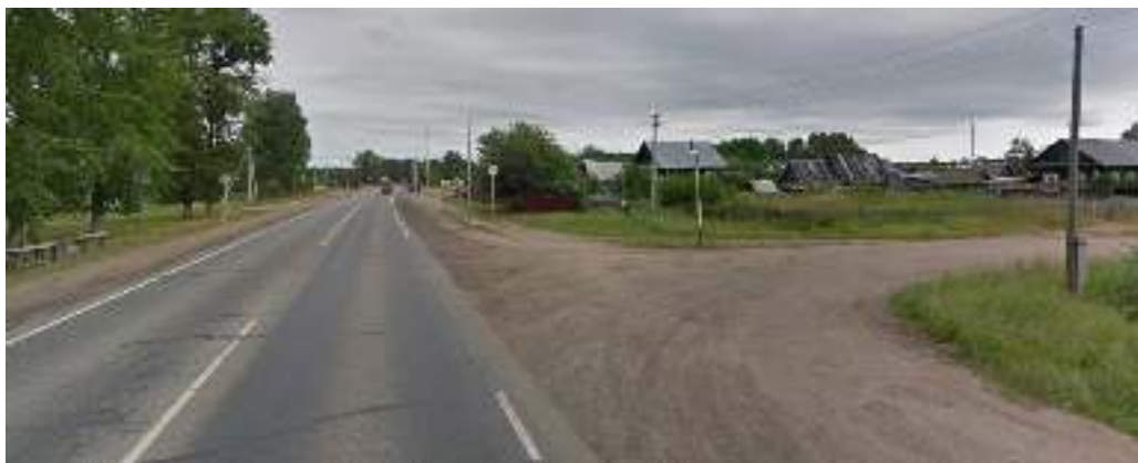
Рис.4 Км 202+400 справа (ПК 0+52) Примыкание в улицу Школьная имеет а/б покрытие. Состояние неудовлетворительное
