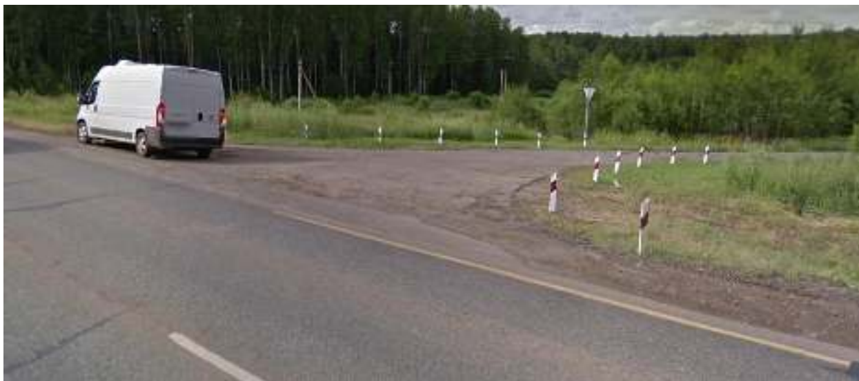
Рис. 34 Км 211+1000 слева. Примыкание к объекту имеет а/б покрытие. Состояние неудовлетворительное
