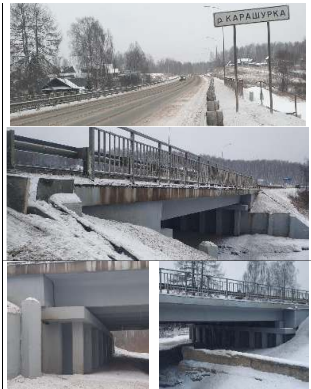
Рис. 27 Км 210+600. ПК33+73 Мост через реку Карашурка Состояние неудовлетворительное.
