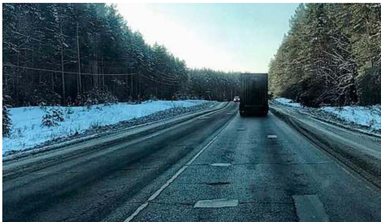
Рис.3 Состояние покрытия. Выкрашивание покрытия, продольные и поперечные трещины на полную глубину ДО, колея - 5-7 см, неровности от ямочного ремонта.
