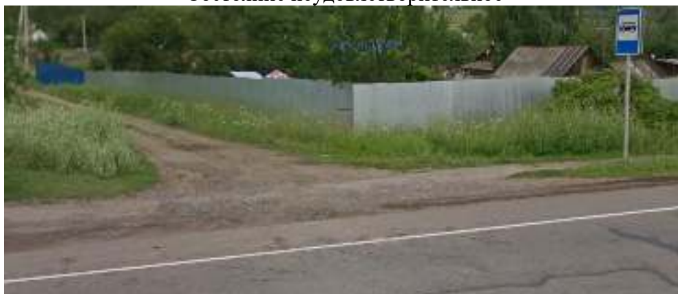
Рис. 23 Км 210+378 слева. Примыкание в улицу имеет пгс покрытие. Состояние неудовлетворительное
