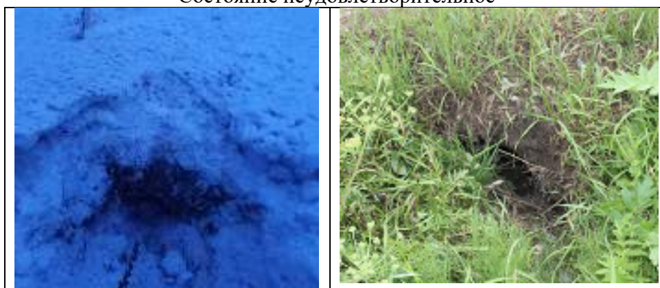
Рис. 3 Км 207+050 (ПК 0+52) слева Труба d=0.4 Состояние неудовлетворительное.
