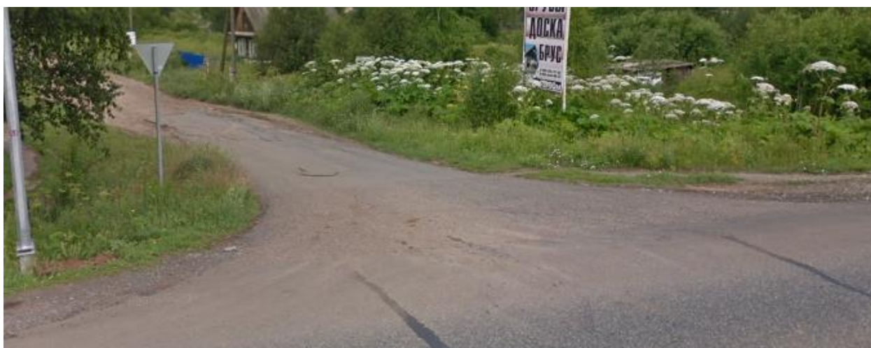
Рис. 26 Км 210+463 справа. Примыкание к н.п. Липовка имеет а/б покрытие. Состояние неудовлетворительное
