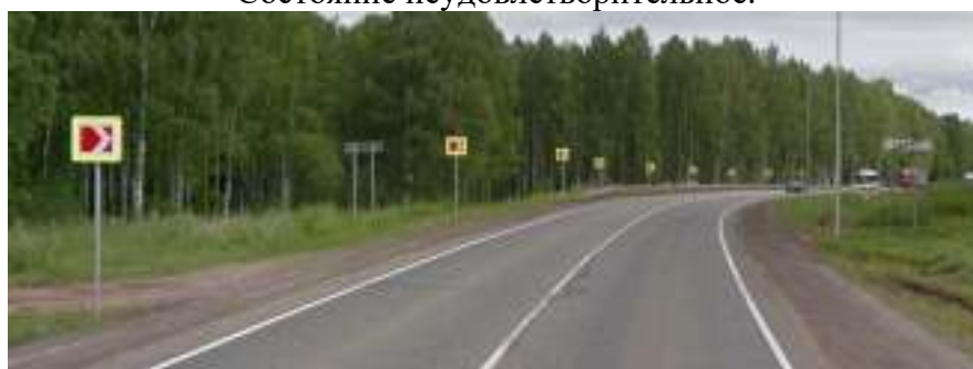
Рис. 28 Км 210+870 слева. Примыкание в улицу имеет пгс покрытие. Состояние неудовлетворительное Км 210+900 справа. Примыкание в улицу имеет пгс покрытие. Состояние неудовлетворительное
