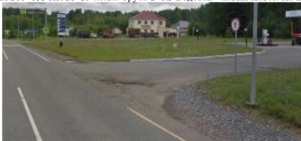
Рис. 21 Км 210+296 справа. Примыкание к АЗС имеет а/б покрытие. Состояние неудовлетворительное
