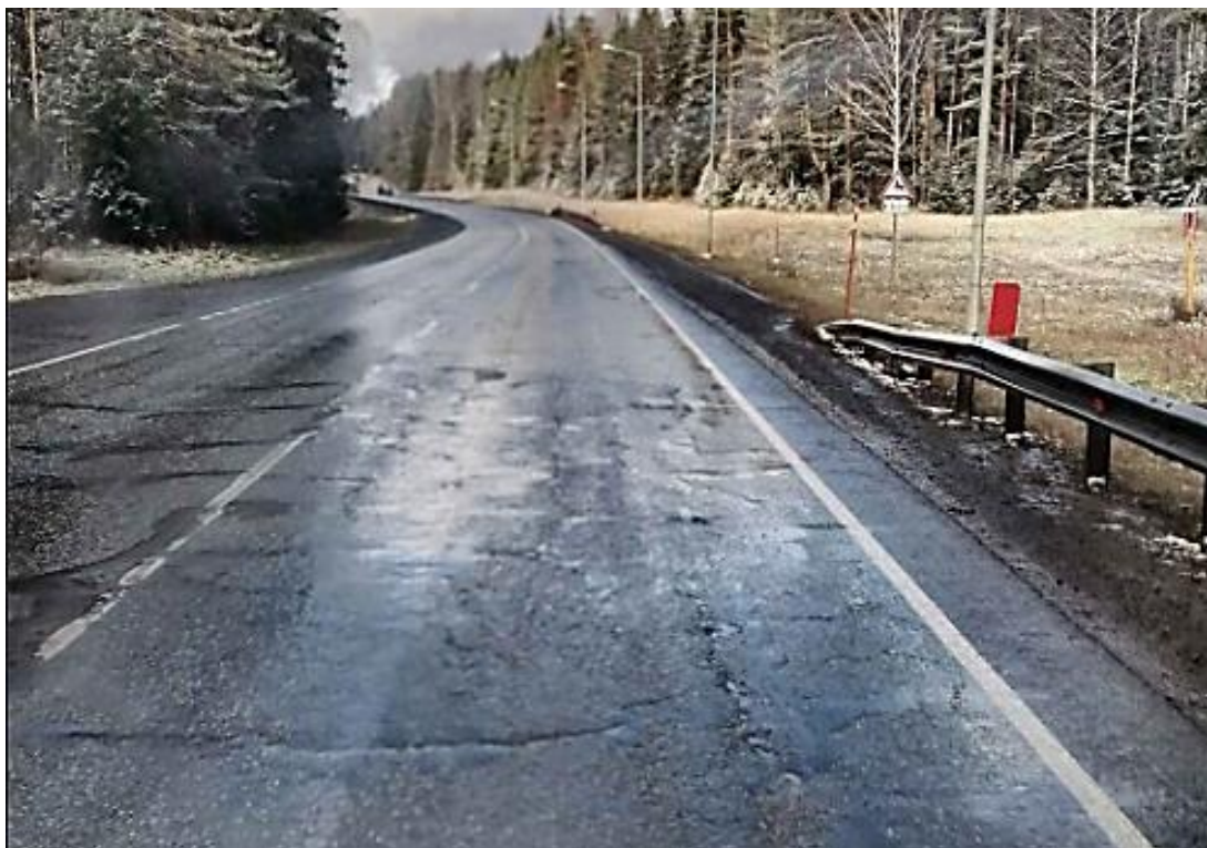
Рис.4 Состояние покрытия, правая сторона. Выкрашивание покрытия, продольные и поперечные трещины на полную глубину ДО, колея - 5-7 см.
