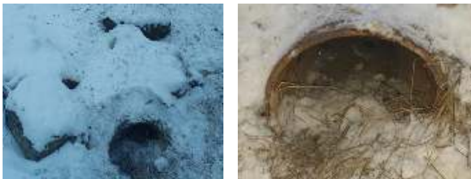
Рис. 20 Км 210+053 ПК 28+39 слева. Труба d=0.5 Водоток – левый кювет. Не на балансе.
