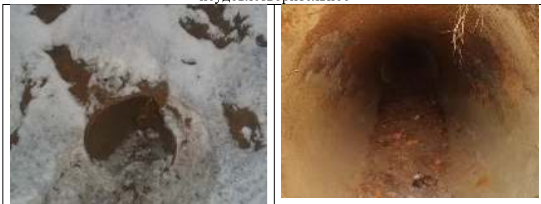
Рис. 15 Км 204+598 (ПК 37+28) слева Труба металл d=0.3. Водоток-левый кювет Состояние неудовлетворительное.
