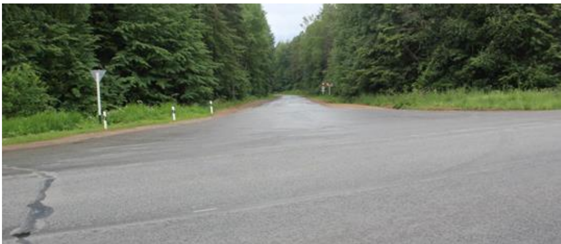
Рис.4 Км 207+265 слева. Примыкание к н.п. Чур имеет а/б покрытие. Состояние неудовлетворительное
