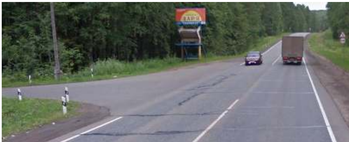
Рис.19 Км 205+931 слева. Примыкание к санаторию имеет а/б покрытие. Состояние неудовлетворительное
