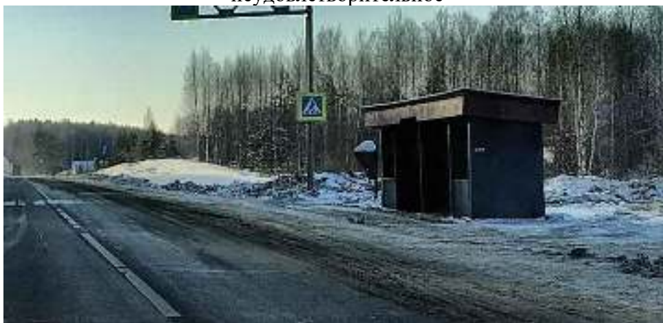
Рис. 22 Км 210+359 (слева). Автобусная остановка. Наименование «Карашурка». Состояние неудовлетворительное
