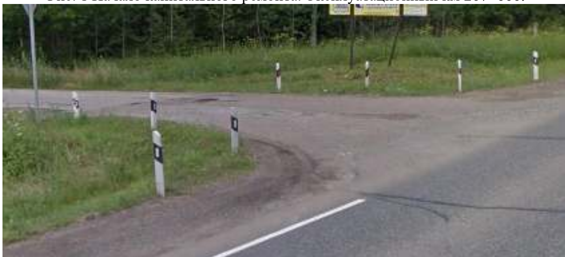
Рис.2 Км 207+050 слева (ПК 0+52) Примыкание в детский лагерь имеет а/б покрытие. Состояние неудовлетворительное
