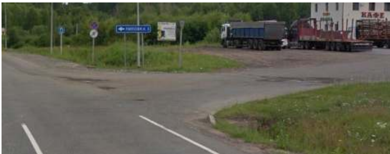
Рис. 24 Км 210+378 справа. Примыкание к АЗС имеет а/б покрытие. Состояние неудовлетворительное
