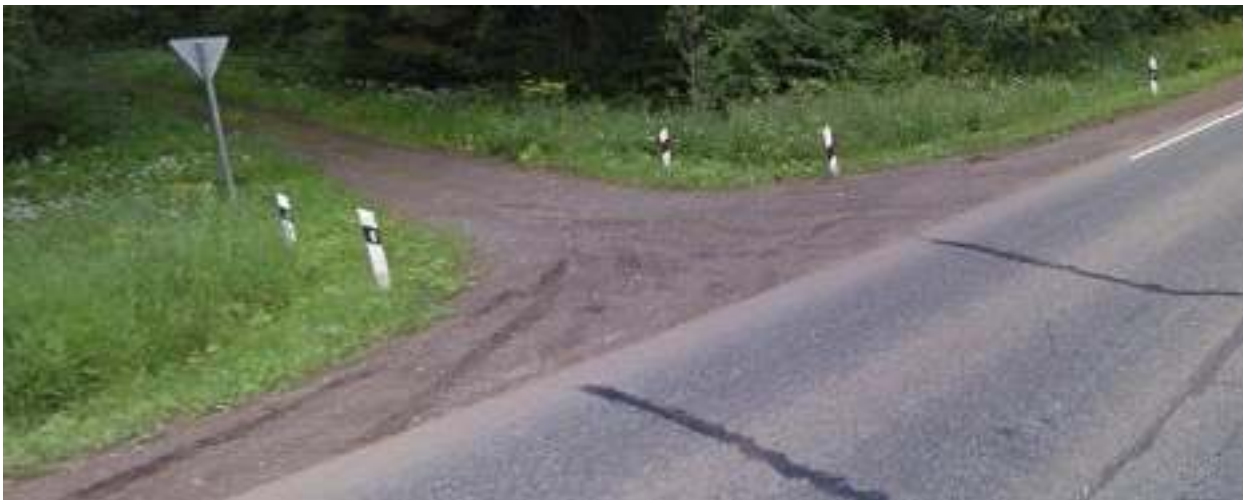
Рис.22 Км 206+696 слева. Примыкание к объекту имеет щебеночное покрытие. Состояние неудовлетворительное
