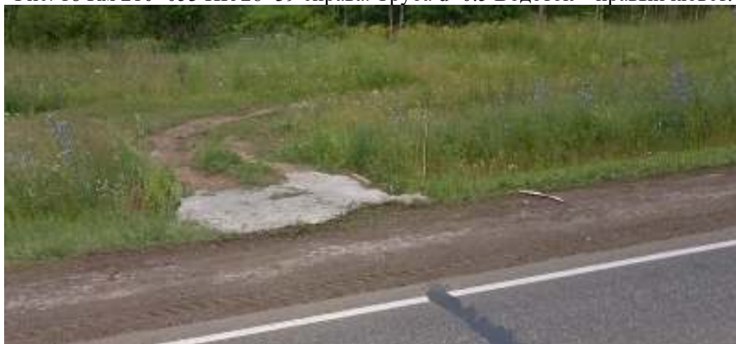
Рис.19 Км 210+053 ПК 28+39 слева. Примыкание к жилым домам имеет бетонное покрытие. Состояние неудовлетворительное
