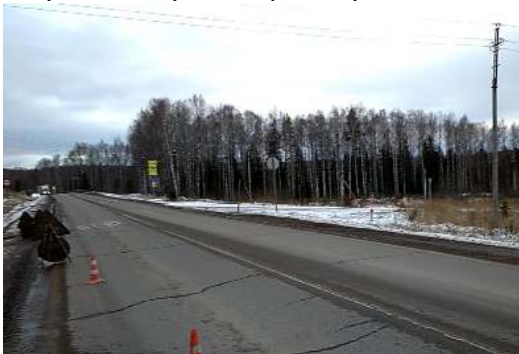
Рис.1 Состояние покрытия. Выкрашивание покрытия, продольные и поперечные трещины на полную глубину ДО, колея - 5-7 см.
