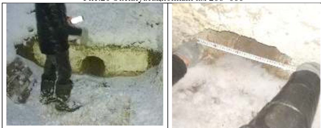
Рис. 21 Км 206+030 (ПК 51+75) по основной трассе Труба d=1.4 Состояние неудовлетворительное.
